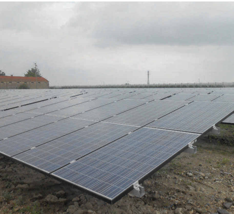
L'impianto di Copparo (FE) rientra negli interventi volti all'efficientamento energetico promossi dalla giunta comunale a seguito dell'adesione al Patto dei Sindaci
