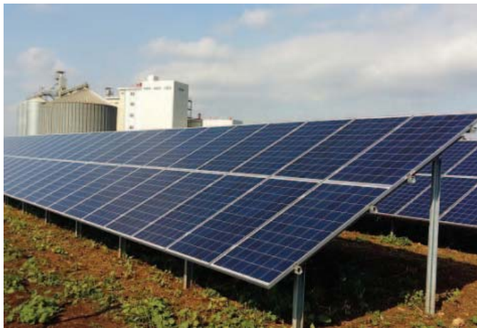
Figura 3 L'impianto fotovoltaico da 320 kW a servizio dell'Azienda Molitoria "San Paolo" di Siracusa (foto per gentile concessione di Solare B2B).
