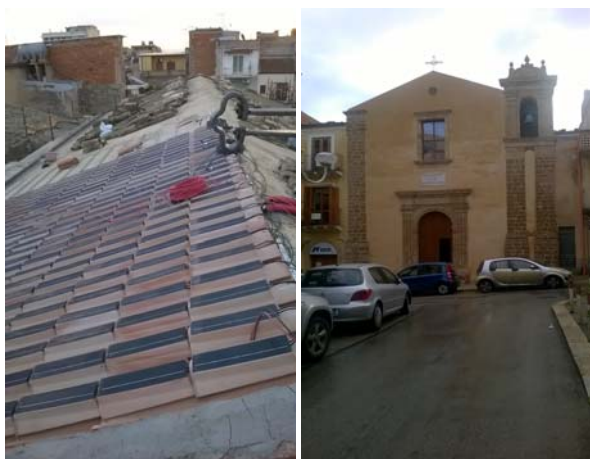
Figura 5. Gela: il tetto della ex Chiesa di S. Giovanni Battista, rifatto insieme agli interni nel 2015, è solarizzato con un impianto fotovoltaico da 6 kW costituito da tegole in cotto fotovoltaiche.
