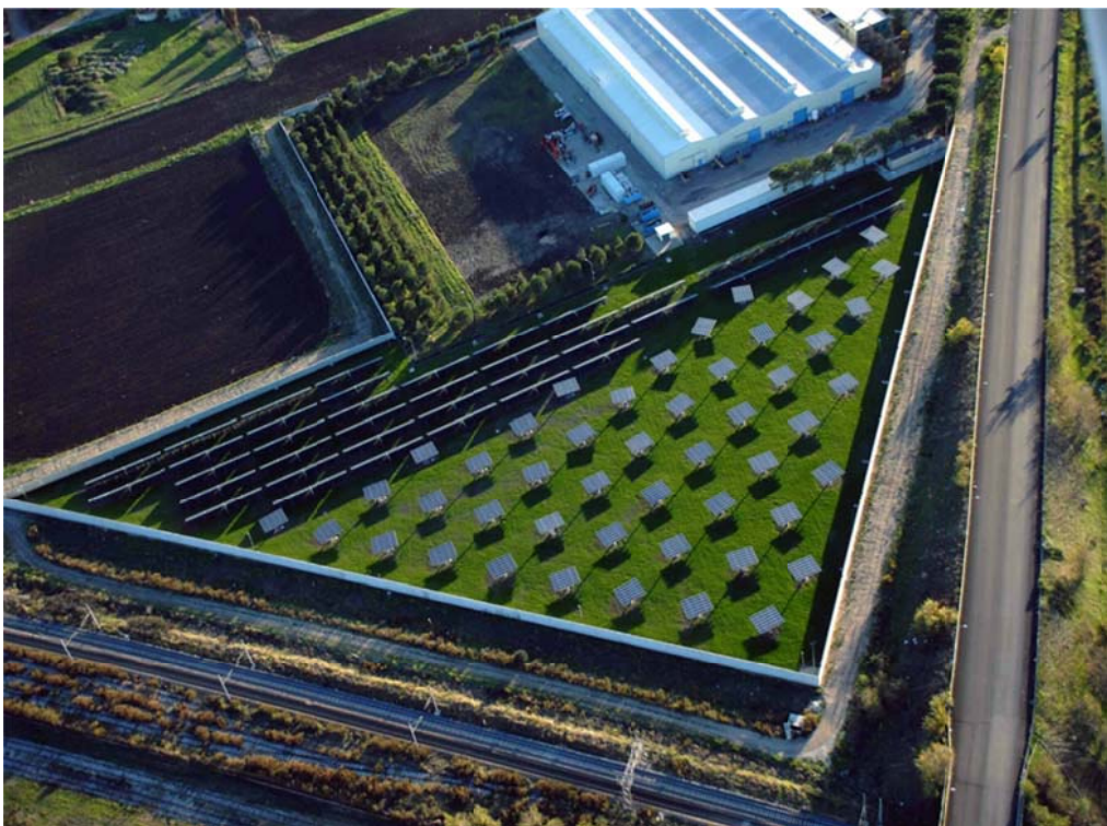
Figura 2: Impianto fotovoltaico che alimenta un Unità di Consumo
