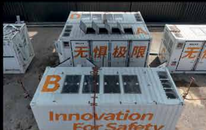
Container batteria DC in configurazione di test
