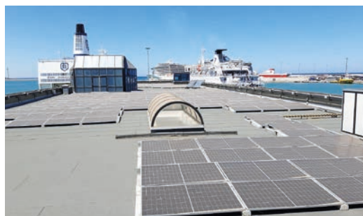
L'IMPIANTO PREVEDE 380 PANNELLI IN SILICIO MONOCRISTALLINO
