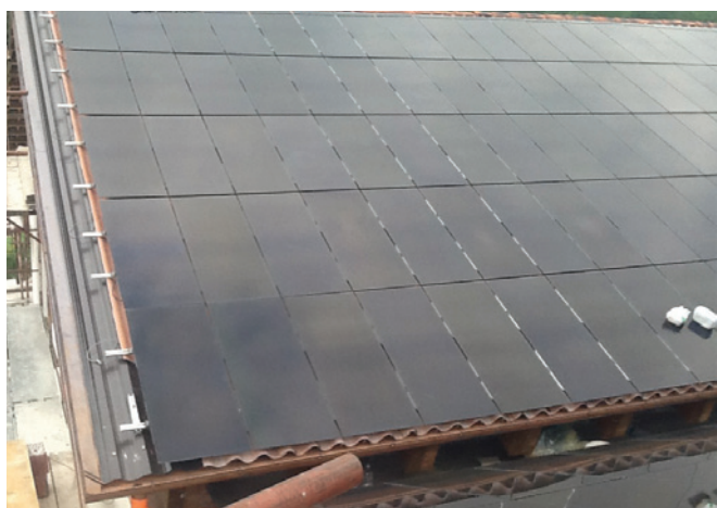
L'IMPIANTO FOTOVOLTAICO DA 62 KWP, CHE UTILIZZA 4 INVERTER FRONIUS IG PLUS 150, È GESTITO DALL'AZIENDA VINICOLA VIETTI DI SERRALUNGA D'ALBA (CN) AL 100% IN AUTOCONSUMO
