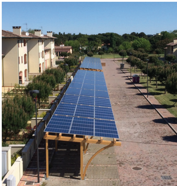
LE STRUTTURE IN LEGNO OSPITANO 440 MODULI SUNRISE SOLARTECH COLLEGATI A 10 INVERTER POWER-ONE PER UNA PRODUZIONE STIMATA DI 120.000 KWH/ANNO
