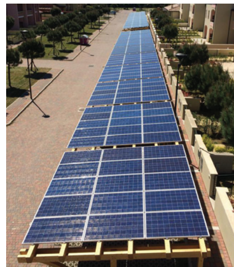
L'IMPIANTO FOTOVOLTAICO RIENTRA NELL'AMBITO DEL PROGETTO MARE GESTITO DA PFF GROUP-LA CASA DELLE NUOVE ENERGIE DI FERRARA CHE PREVEDE INTERVENTI DI RIQUALIFICAZIONE ENERGETICA IN CAMPEGGI, STRUTTURE BALNEARI, RISTORANTI E ALBERGHI
